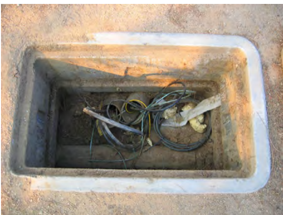
HH BB (2) 4" conduits to HH #CC
