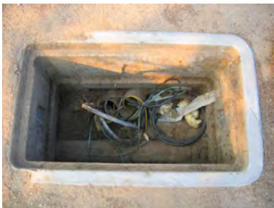
HH BB (2) 4" conduits to HH #CC
