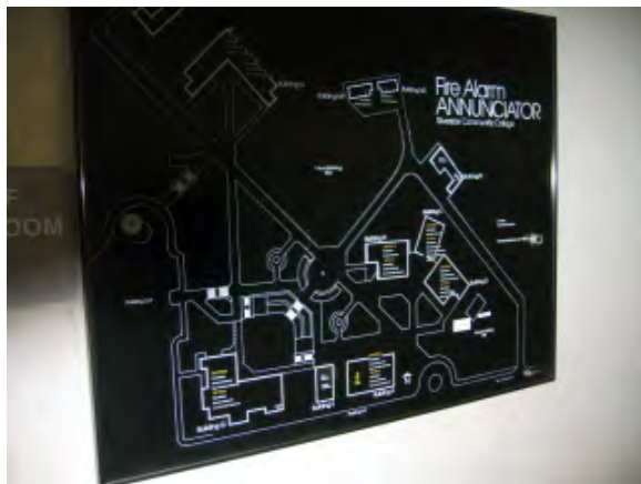
Fire Alarm Annunciator
