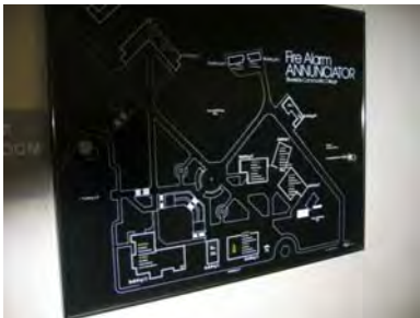
Fire Alarm Annunciator
