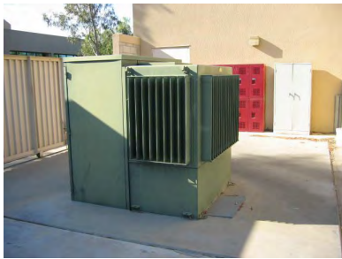
SCE 750 kVA Transformer
