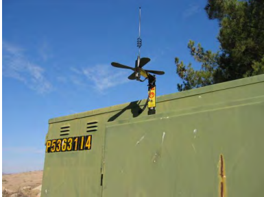
SCE HV Switch w/ Meter Antenna
