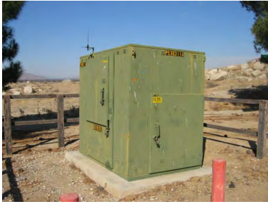
SCE High Voltage Switch
