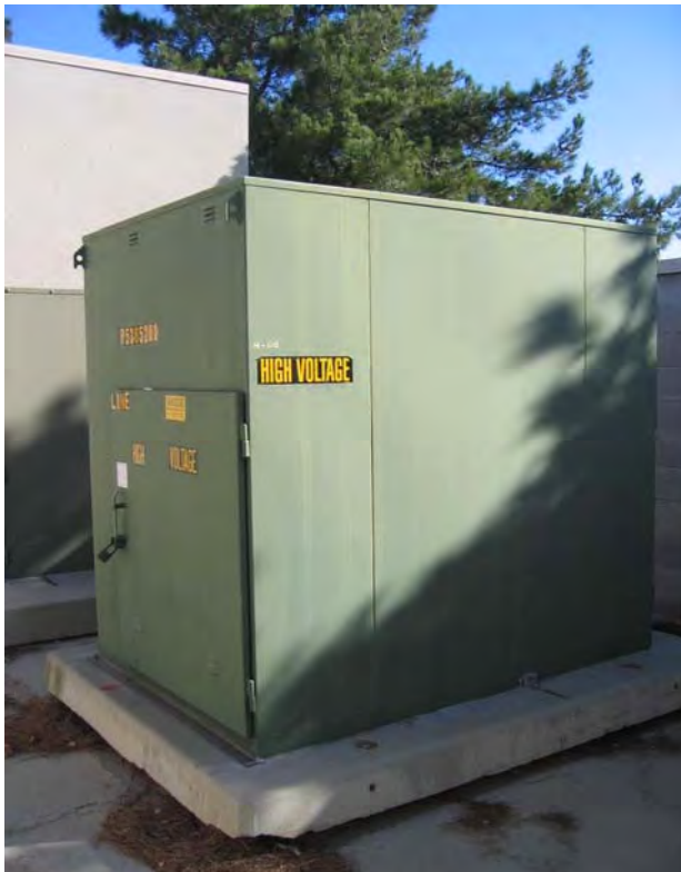
SCE HV Switch
