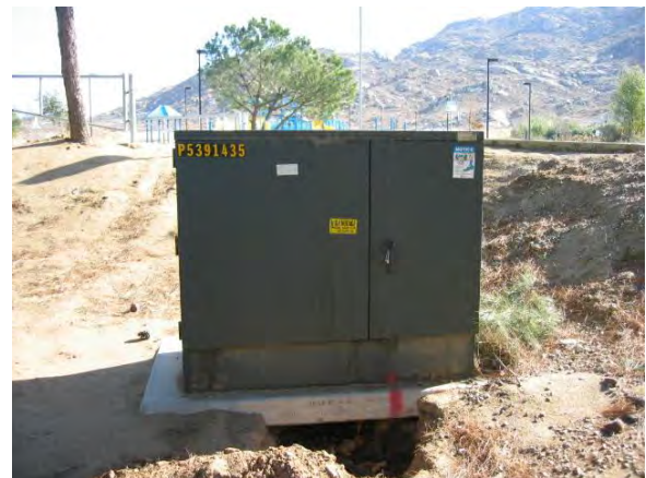
SCE 150 kVA Transformer
