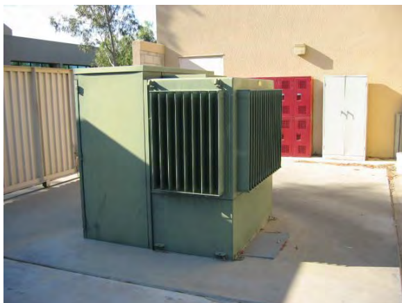
SCE 750 kVA Transformer
