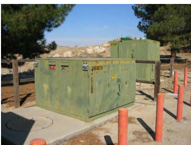
SCE Capacitor Bank
