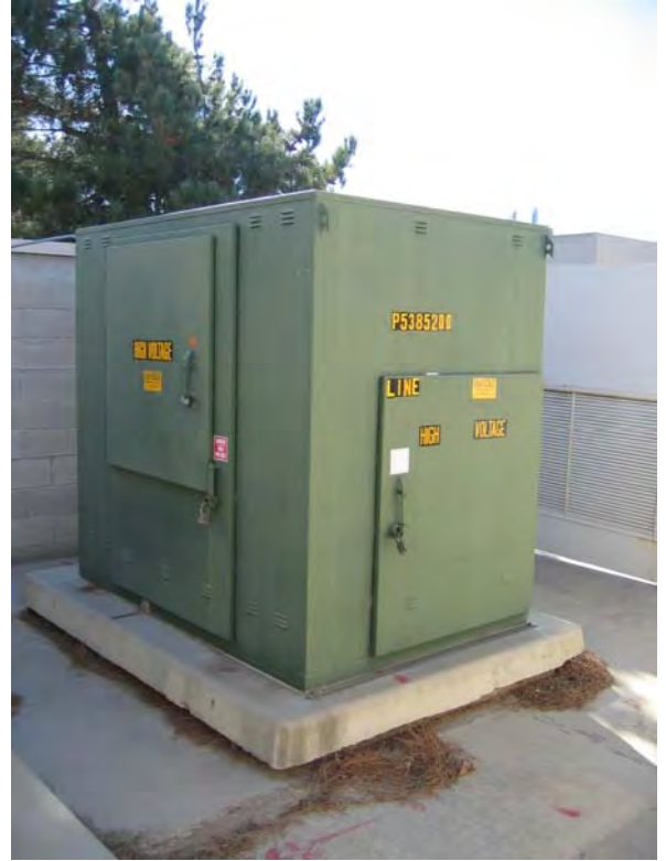
SCE HV Switch
