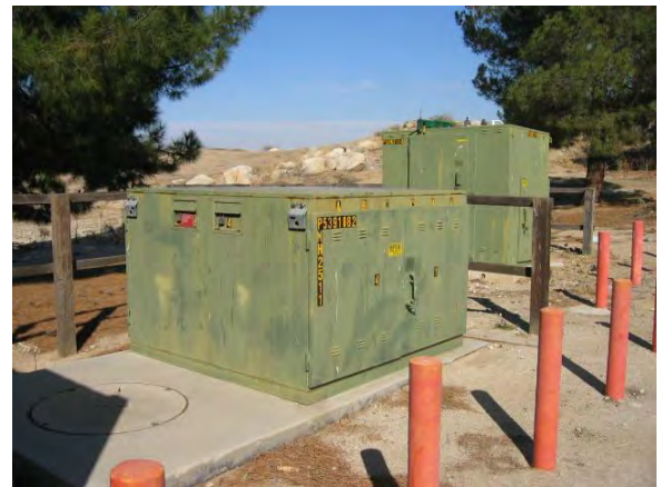
SCE Capacitor Bank
