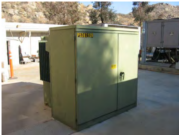
SCE 750 kVA Transformer
