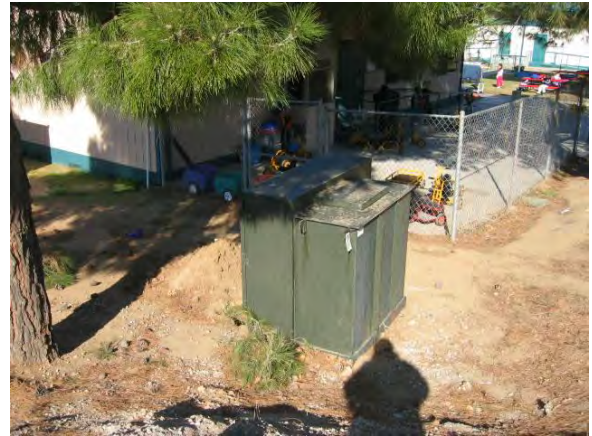
SCE 150 kVA Transformer
