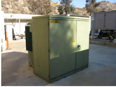
SCE 750 kVA Transformer
