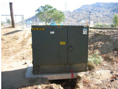
SCE 150 kVA Transformer
